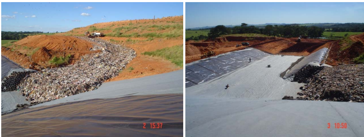
FIGURA 5 – Obras de ampliação da 4ª célula do atual Aterro Sanitário Municipal de São Carlos/SP. Fonte: PMSC (2007). Fotos: Carlos A. Talarico
