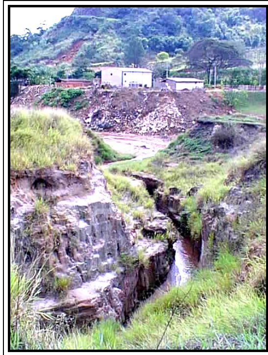
FIGURA 13 - Erosão - Cidade Aracy FOTO: Mariana Naxara Poli - 2002
