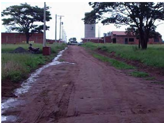
FOTO B.4.10. rua longitudinal sem guia e sarjeta (foto da autora)
