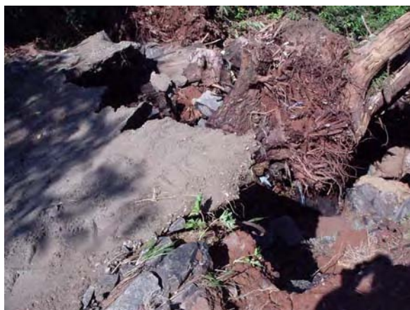
FOTOS B.3.18 . Detalhe do início do solapamento do enrocamento à jusante da estrutura (foto da autora).
