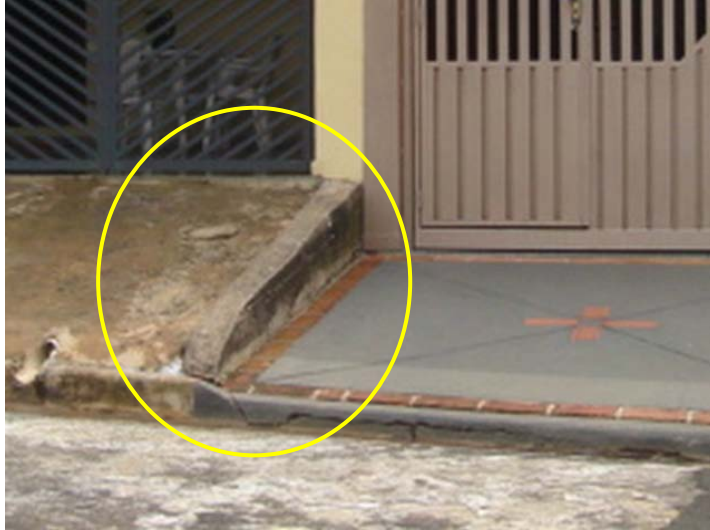
FOTOS B.1.1. Calçadas obstruindo a passagem de pedestres (fotos da autora).
