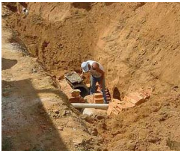
FOTO B.5.43. Reconstrução da rede de Esgoto no Presidente Collor (SÃO CARLOS, 2004).
