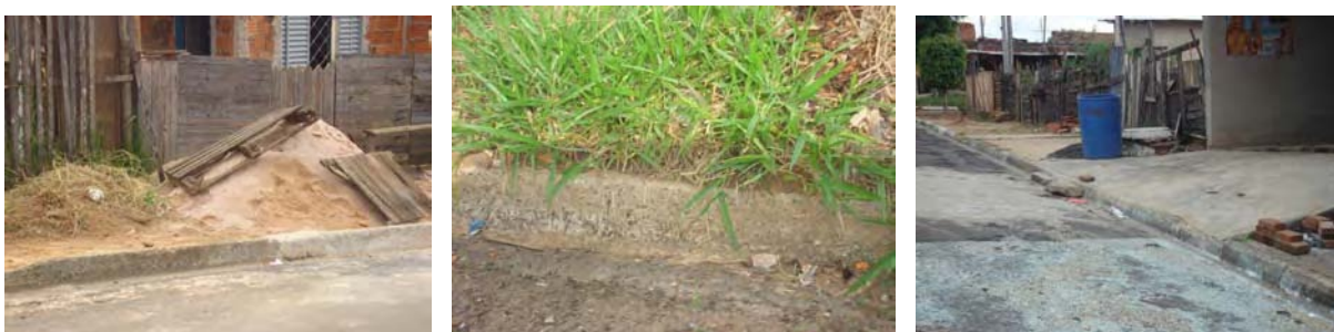
FOTOS B.6.12 e B.6.13. Presença de materiais de construção, vegetação e outros materiais nas calçadas impedindo a passagem de transeuntes (fotos da autora).
