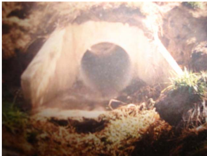
FOTO B.7.42. Detalhe do muro de ala junto à saída da tubulação da rua Gervasio Cyrino (SÃO PAULO, 2002a).
