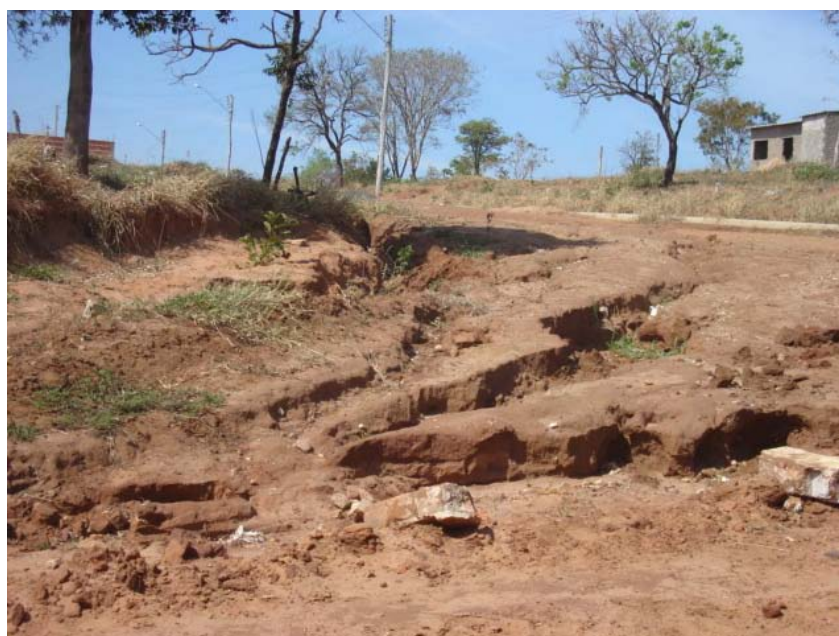
FOTO B.6.2. Processo erosivo em decorrência da falta de um sistema de drenagem (foto da autora).
