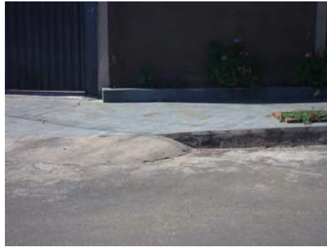
FOTO B.1.27. Guias e sarjetas obstruídas por rampas para entrada de veículos (foto da autora)
