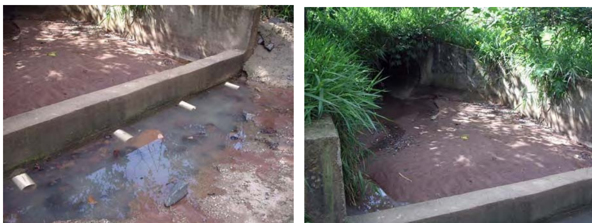
FOTOS B.3.14 e B.3.15. Vista da estrutura para dissipação de energia das galerias da Sub-Bacia III (fotos da autora).
