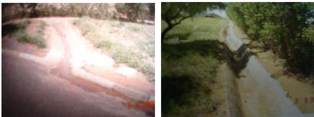
FOTOS B.7.31 e B.7.32. Canaleta para escoamento da água pluvial (SÃO PAULO, 2002a).
