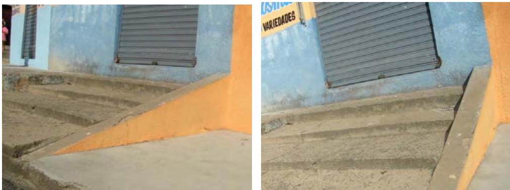
FOTOS B.5.20 e B.5.21. Escadas nas calçadas, impedindo a passagem de transeuntes (fotos da autora)
