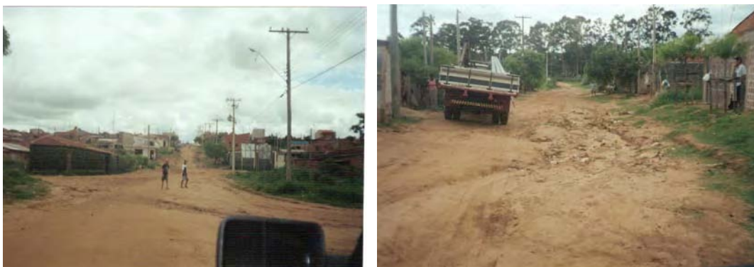
FOTO B.5.13 e B.5.14. Rua T – sem calçada, guia, asfalto, sarjeta em 10/12/2001 (fotos da autora)
