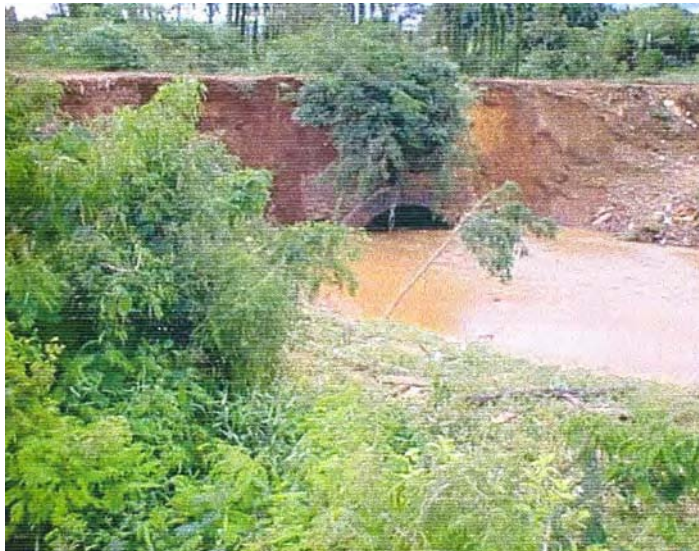
FOTO B.6.28. ponte sobre o córrego Água Quente. Processo intenso de assoreamento. Lâmina d'água com 20 cm de largura. Foto de 27/02/99 (GASPAR, 2000).
