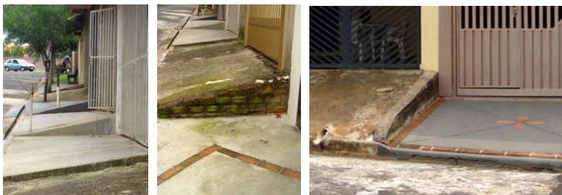
FOTOS B.2.7, B.2.8 e B.2.9. Calçadas obstruindo a passagem de pedestres (fotos da autora).
