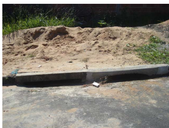
FOTO B.2.52. Lançamento de resíduos e materiais indevidos na boca-de-lobo (foto da autora)
