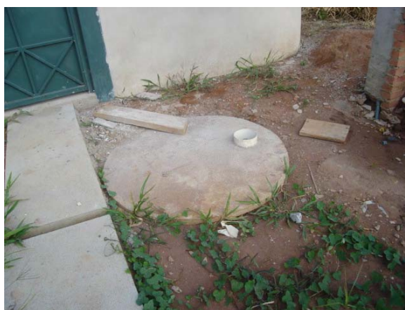
FOTO B.9.15. Poço de retenção de águas pluviais (foto da autora).
