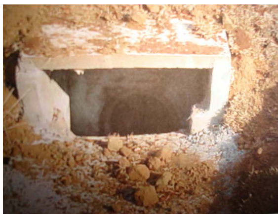
FOTO B.7.40. Detalhe da estrutura de captação (SÃO PAULO, 2002a).
