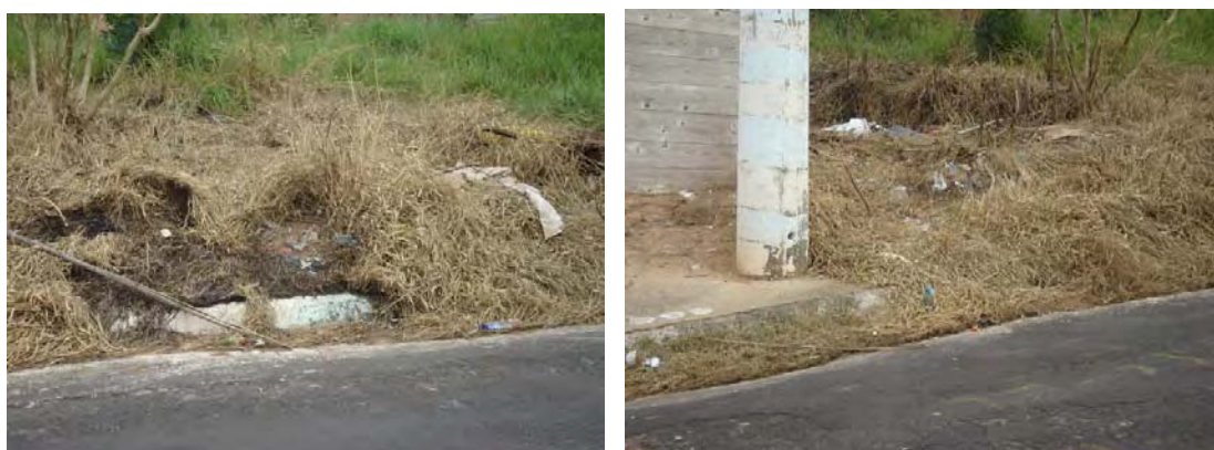
FOTOS B.6.49 e B.6.50. Guias e sarjetas obstruídas (fotos da autora)
