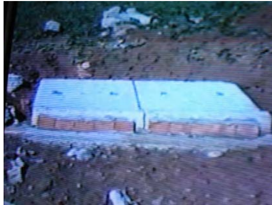
FOTO B.2.44. Boca-de-lobo tampada para evitar entrada de resíduos sólidos e solo durante a implantação do empreendimento (KONDOR, 1996).
