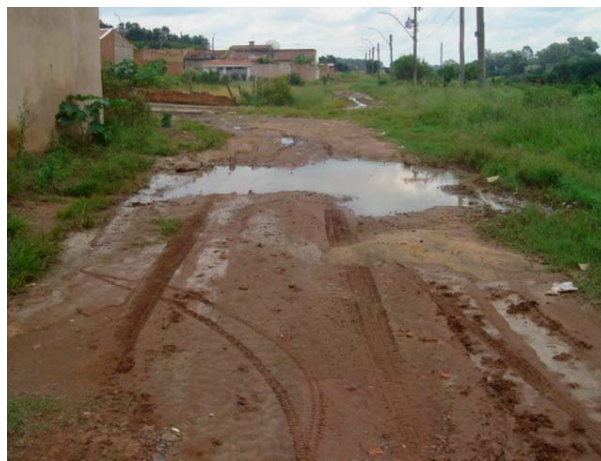
FOTOS B.2.5. Última rua do empreendimento sem pavimentação asfáltica, guias e sarjetas (fotos da autora).
