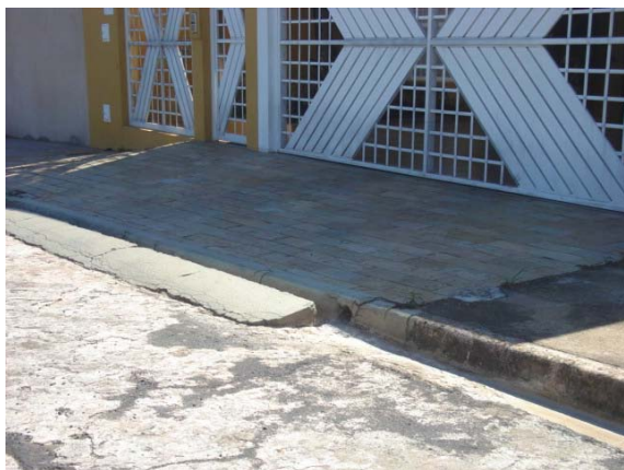
FOTO B.2.49. Guias e sarjetas obstruídas por rampas para entrada de veículos.
