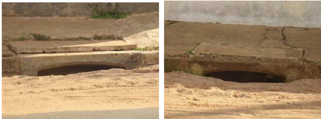
FOTOS B.6.45 e B.6.46. Bocas-de-lobo deterioradas e com entradas obstruídas por resíduos sólidos (fotos da autora)
