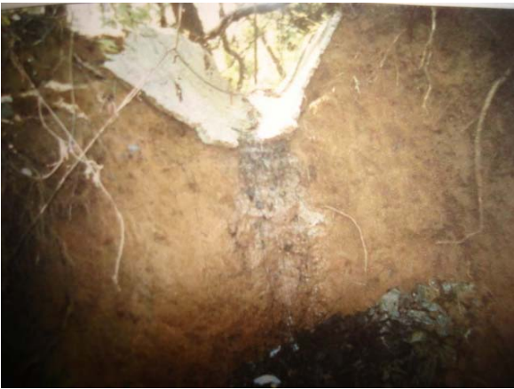
FOTO B.7.35. detalhe da água escoando junto ao solo desprotegido (SÃO PAULO, 2002a).
