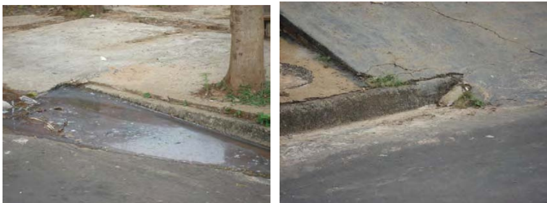
FOTOS B.6.47 e B.6.48. Guias e sarjetas obstruídas (fotos da autora)
