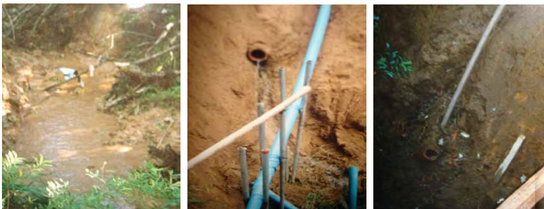
FOTOS B.7.24, B.7.25 e B.7.26. Destruição da rede de água e esgoto em virtude da erosão na área de preservação permanente do loteamento Parque Fehr (SÃO PAULO, 2002a)..
