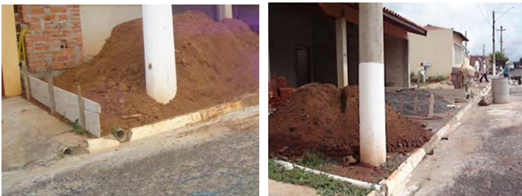
FOTO B.7.6 e B.7.7. Calçadas com presença de materiais de construção, obstruindo a passagem de pedestres (foto da autora)
