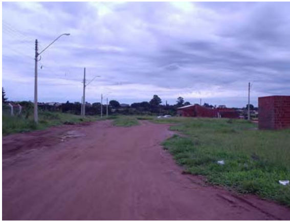
FOTO B.4.42. Rua longitudinal sem guia e sarjeta (foto da autora)
