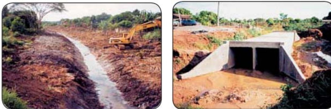
Figura 2.21 Sugestão de Obra segundo o Manual de Saneamento da Funasa - Retificação de Canal Natural, Galeria de Concreto Armado.
