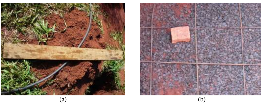
FIGURA 4. 13- a-) madeira utilizada como régua para nivelar o fundo após concretagem. b-) uso de tijolo maciço como referência de altura de concretagem ( fonte: Habis, 2009 ).
