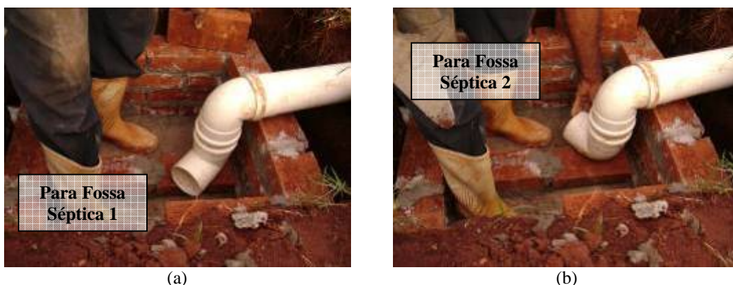
FIGURA 4. 29- a e b-) detalhe da mudança de fossa séptica na primeira caixa de passagem (fonte: Habis, 2009).
