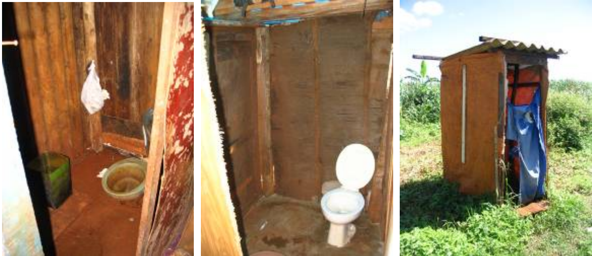
FIGURA 2. 10- Banheiros existentes no assentamento, com uso de fossas negras ( fonte: Habis, 2006 ).
