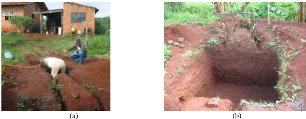
FIGURA 4. 17- a-) abertura das valas para passagem da tubulação. b-) fossa séptica assoreada devido as chuvas (fonte: Habis, 2009).
