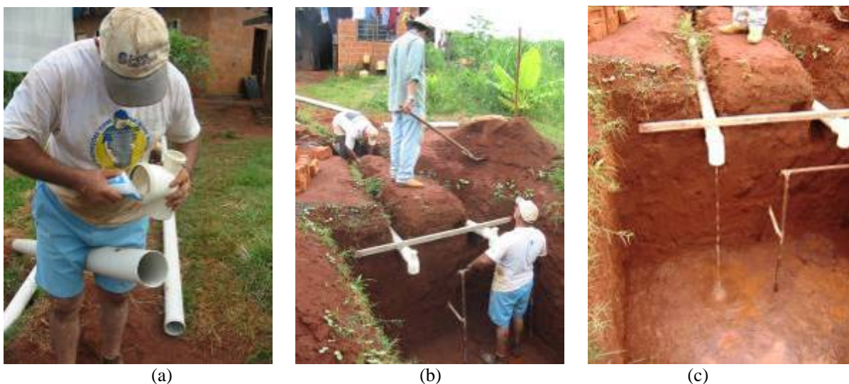
FIGURA 4. 33- a-) execução da conexão entre tubo e joelho com visita. b) nivelamento das unidades de entrada de esgoto na fossa séptica. c-) verificação do deslocamento do efluente na tubulação ( fonte: Habis, 2009 ).
