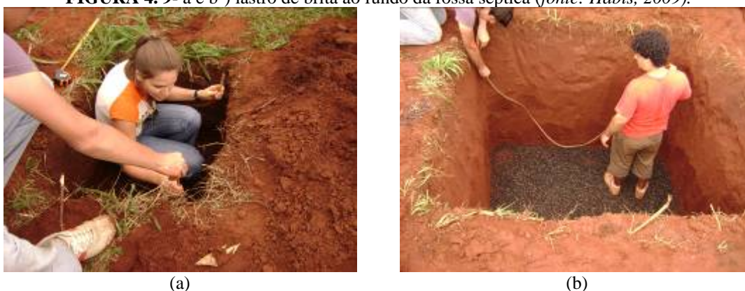
FIGURA 4. 10- a-) verificação de nível após aplicação de lastro de brita na caixa de passagem. b-) verificação de nível após aplicação de lastro de brita na fossa séptica (fonte: Habis, 2009).
