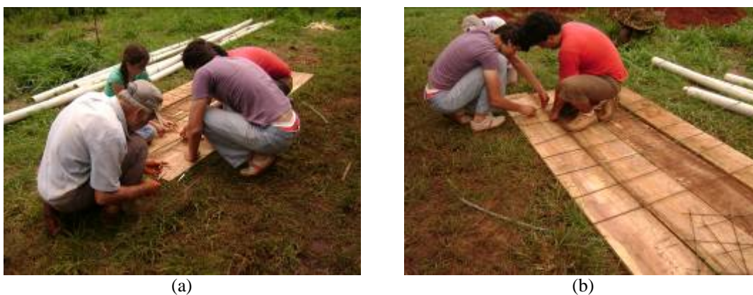
FIGURA 4. 8- a e b-) preparação da armadura da fossa séptica pelos moradores e equipe Habis (fonte: Habis, 2009).
