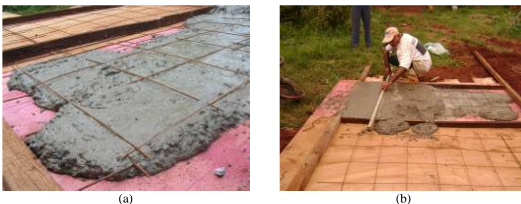
FIGURA 4. 25- a-) detalhe da armadura dupla das tampas da fossa séptica. b-) concretagem das tampas da fossa séptica e sarrafeamento (fonte: Habis, 2009).
