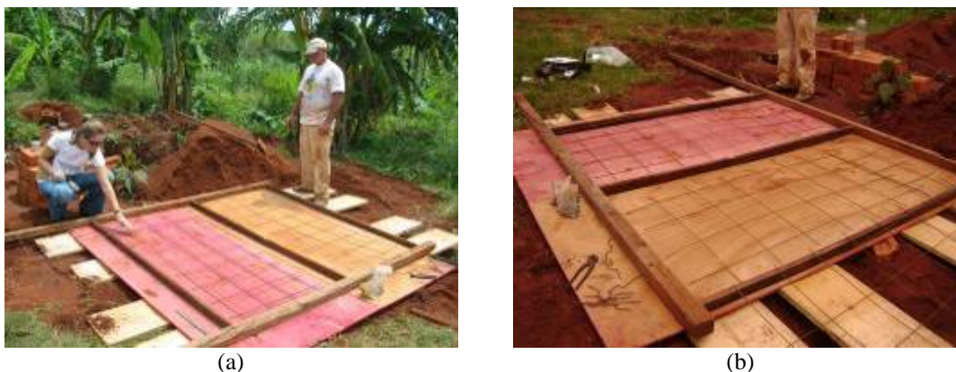
FIGURA 4. 21- a e b-) malha de ferro para concretagem das tampas e nivelamento (fonte: Habis, 2009).
