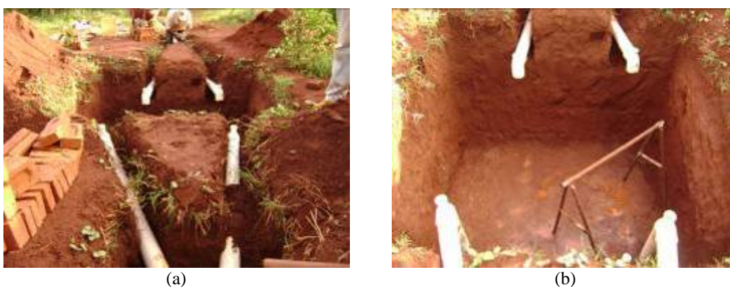
FIGURA 4. 35- a-) vista geral das tubulações e b-) detalhe da tubulação da fossa séptica ( fonte: Habis, 2009 ).
