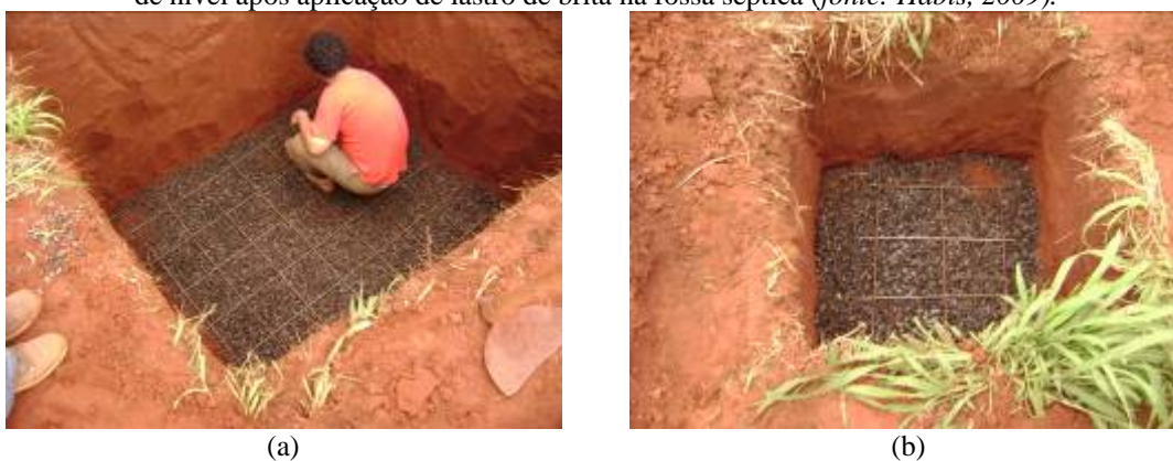
FIGURA 4. 11- a-) ajuste da armadura de fundo na fossa séptica. b-) ajuste da armadura de fundo na primeira caixa de passagem (fonte: Habis, 2009).
