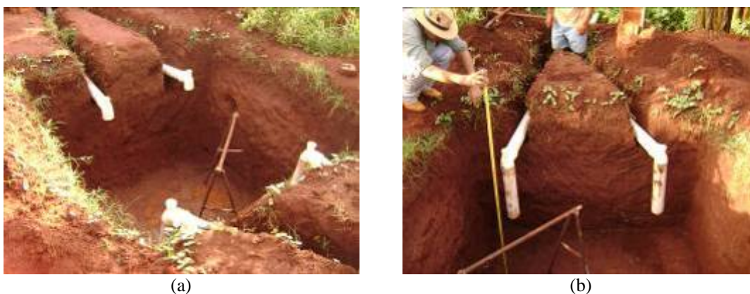
FIGURA 4. 34- a-) detalhe da tubulação de entrada de efluente na fossa séptica. b-) detalhe da tubulação de saída do efluente da fossa séptica ( fonte: Habis, 2009 ).
