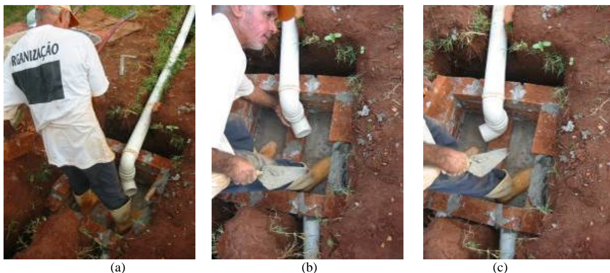
FIGURA 4. 30- a-) detalhe da tubulação de chegada na primeira caixa de passagem. b- e c) detalhe da transferência do efluente para cada unidade da fossa séptica ( fonte: Habis, 2009 ).
