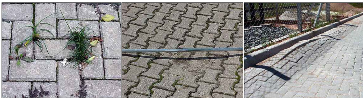
Figura 2.8, 2.9 e 2.10: Vegetação nas juntas, Desnivelamento da superfície e Deformações
