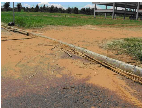
FIGURA 57 - Sistema de microdrenagem implantado – carreamento de sedimentos pelas sarjetas.
