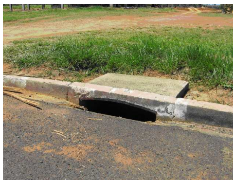
FIGURA 58 - Carreamento de sedimentos pelas sarjetas.
