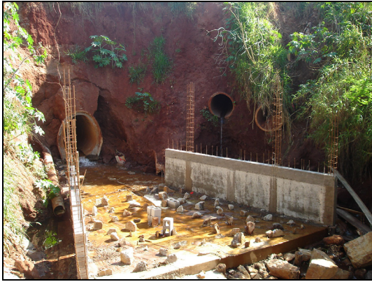
G) Margens expostas; processo erosivo; fonte pontual de poluição; início da construção de um muro de arrimo para contenção das margens.
