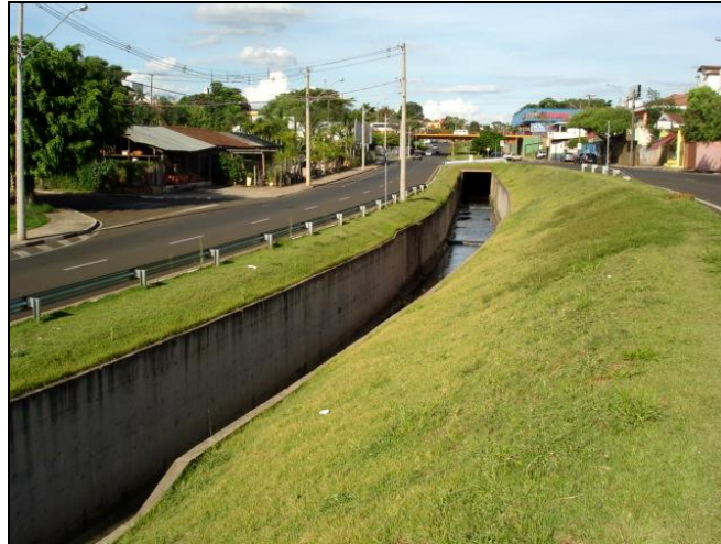
FIGURA 12: Obra concluída de destamponamento e de construção de canal sob o leito de trecho do córrego do Tijuco Preto na região da Avenida Trabalhador São-Carlense. Fonte: Leandro C. Campanelli (2012).
