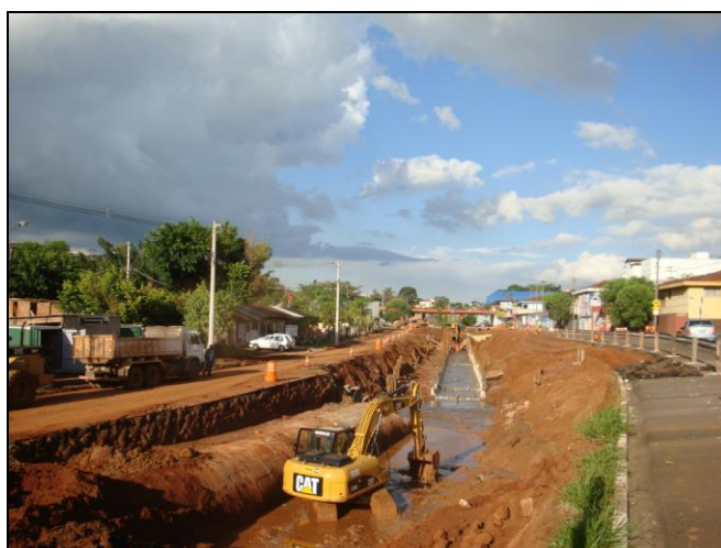
FIGURA 11: Obra de destamponamento e de construção de canal sob o leito de trecho do córrego do Tijuco Preto na região da Avenida Trabalhador São-Carlense. Fonte: Leandro C. Campanelli (2009).
