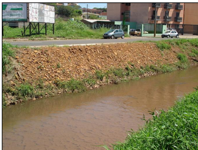
FIGURA 9: Contenção de margem em trecho do rio do Monjolinho, utilizando-se resíduos de construção e demolição, nas proximidades da confluência com o córrego Santa Maria Madalena. Fonte: Leandro C. Campanelli (2009).
