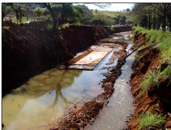
FIGURA 17: Obras de contenção e de estabilização de margens no córrego do Gregório em frente ao SESC, incluindo a construção de canal sob o leito do córrego. Os impactos ambientais associados às obras incluem: aporte de sedimentos para o interior do córrego, assoreamento e aumento da turbidez das águas (prejuízos à biota aquática). Fonte: Leandro C. Campanelli (2012).
