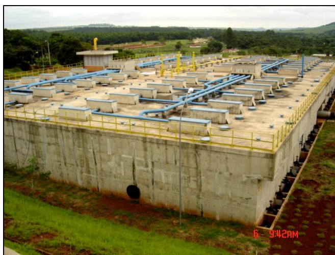
FIGURA 18: Reator anaeróbico de fluxo ascendente de manta de lodo – princípio de básico de funcionamento da Estação de Tratamento de Esgotos de São Carlos (SP) (ETE Monjolinho). Fonte: Leandro C. Campanelli (2009).
