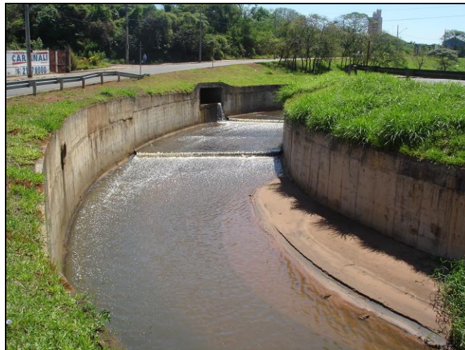
FIGURA 14: Construção de canal sob o leito do rio do Monjolinho na região da Avenida Francisco Pereira Lopes – perímetro urbano de São Carlos (SP). Fonte: Leandro C. Campanelli (2009).
