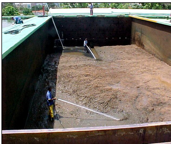
FIGURA 24: Procedimento de lavagem do decantador da Estação de Tratamento de Água (ETA) de São Carlos (SP), visando a remoção de lodo decantado. Fonte: Prof. Dr. João Sergio Cordeiro.
