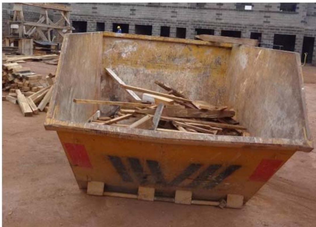
Figura 5. Dispositivo de acondicionamento final com caçamba estacionária.
