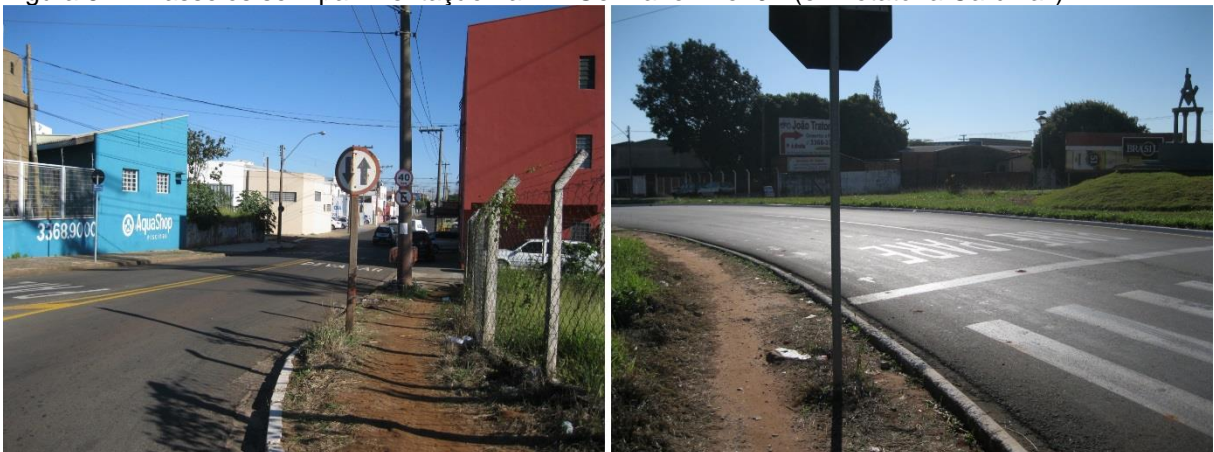
Figura 87 – Passeios sem pavimentação na Av. Germano Fher Jr. (ex. rotatória Cardinali)
