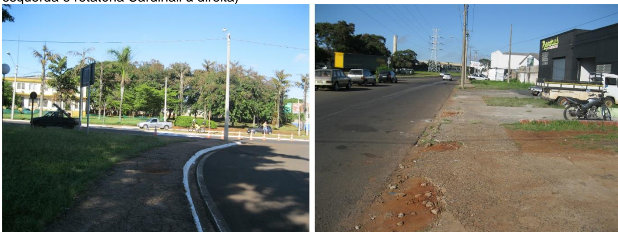
Figura 89 – Pavimento do passeio em péssima condição de conservação (ex. rotatória Praça Itália à esquerda e rotatória Cardinali à direita)
