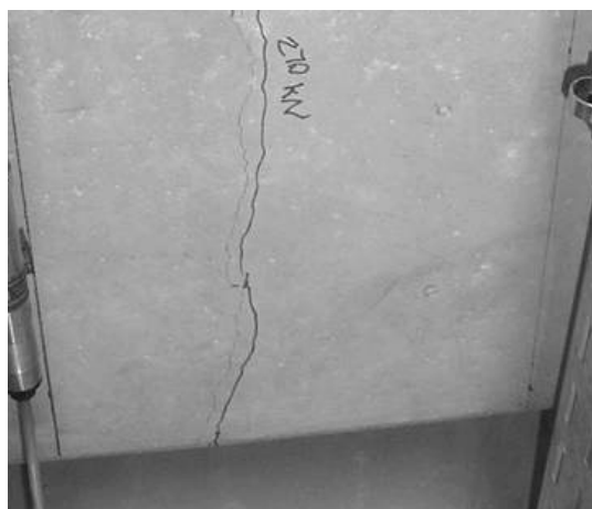
Figura 3-59: Início da fissuração da viga bi-apoiada para uma carga de 270 kN.
