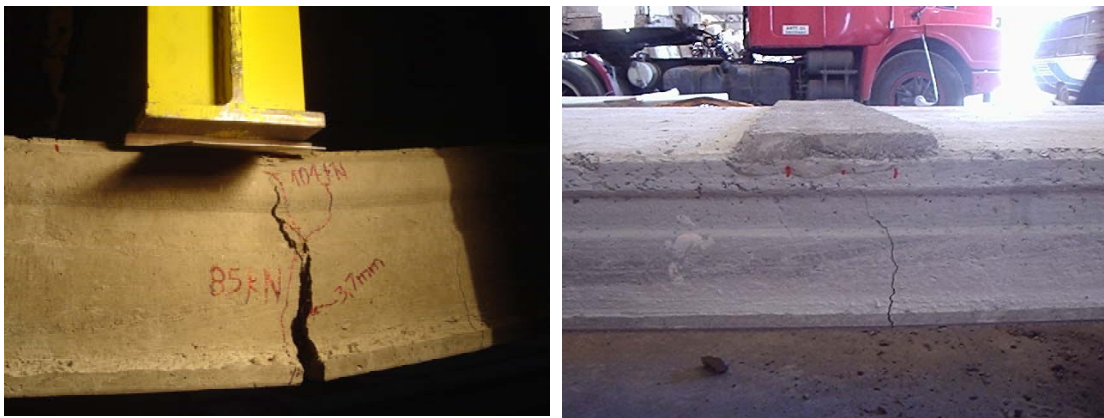
Figura 2.3: Fissuras de flexão em elementos de laje alveolar.
