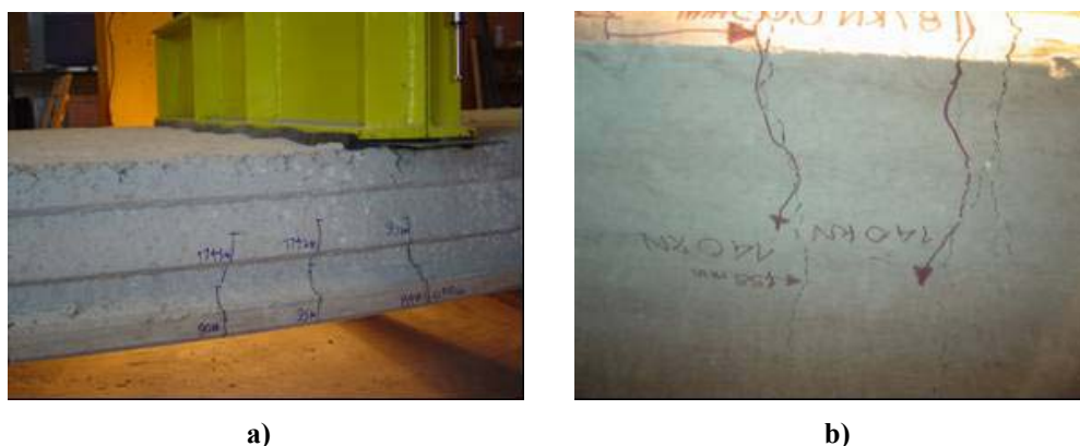
Figura 4.28: Configuração de fissuração da laje L12-20-SC-8_B: a) Vista lateral da região central da laje; b) Vista da superfície inferior da laje.
