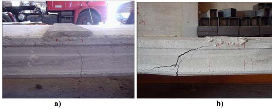
Figura 4.26: Configuração de fissuração para laje de 3,0m de vão, submetida a ensaio de flexão: a) Fissuração da lateral esquerda; b) Fissuração da lateral direita da laje.
