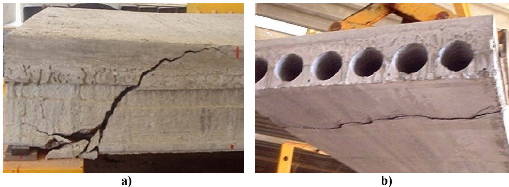
Figura 4.19: Abertura de fissura da laje da Lote A: a) Vista lateral; b) Vista inferior.
