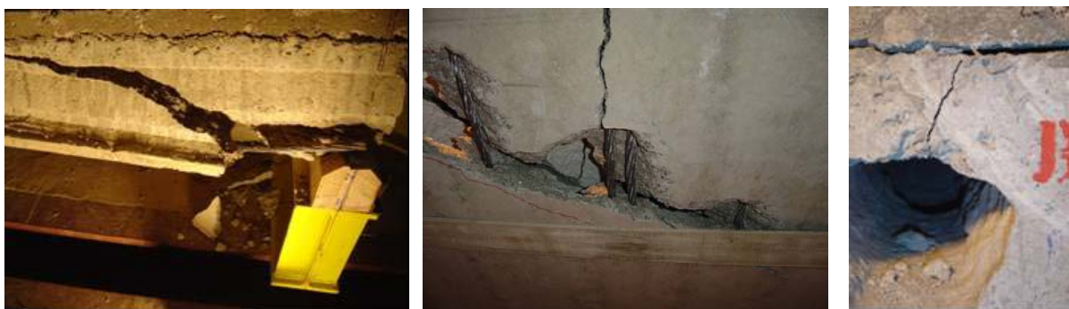
a) Fissuração na parte lateral; b) Fissuração da parte inferior; c) Vista frontal.
