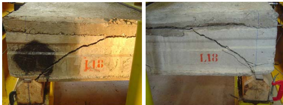
Figura 4.24: Fissuração da laje L18-CC-6_C.
