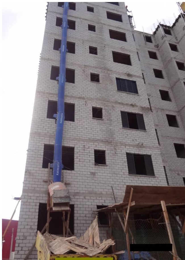
Figura 4.34 – Condutor de Entulho Fonte: Autor, Outubro de 2011
