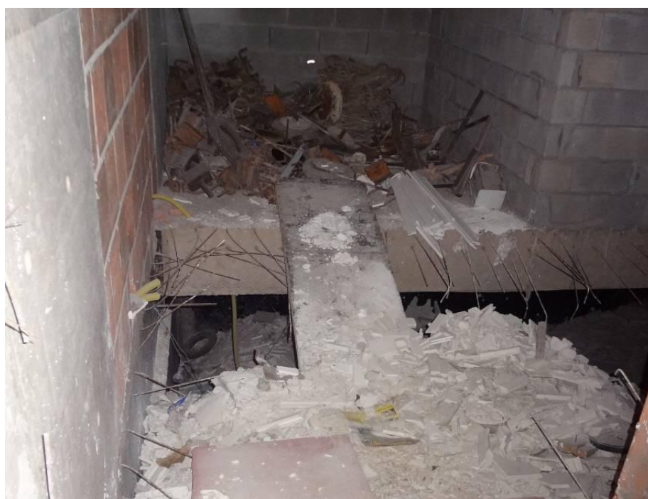
Figura 4.29 – Resíduos de gesso espalhado dentro da edificação Fonte: Autor, Novembro de 2011
