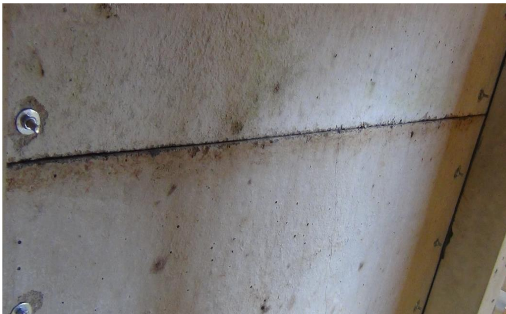
Figura 63: Resultado do ensaio (manchas de água na face oposta da placa)
