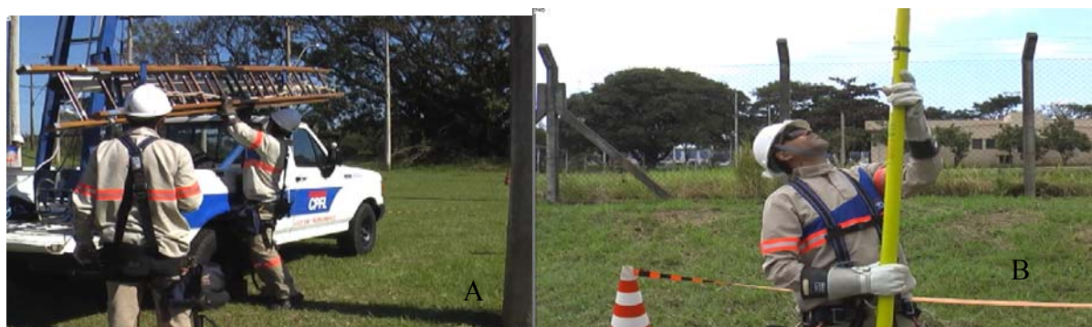
Figura 5: (5A): Retirada e reposicionamento da escada; (5B): Troca do elo fusível – vara telescópica.
