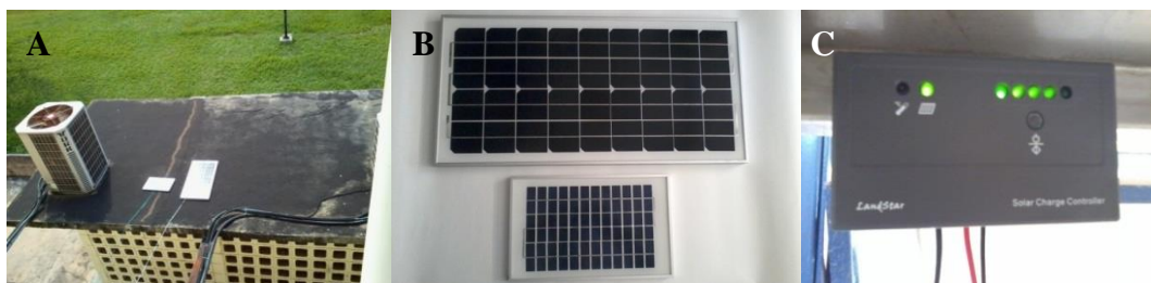
FIGURA 6.14. Placas de captação de energia solar para recarga de baterias chumbo-ácida utilizadas no PG004. Instalação das placas (A) de 20 W (18 V, 1,11 A) e 5 W (18 V, 0,28 A) (B) e microcontrolada em operação (C).
