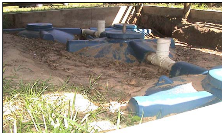
FIGURA 4.3 – Sistema da fossa séptica biodigestora instalado na Fazenda Santa Cândida – São Carlos/SP
