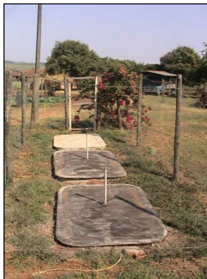
FIGURA 4.1 – Sistema da fossa séptica biodigestora instalado no Sítio Aparecida – São Carlos/SP
