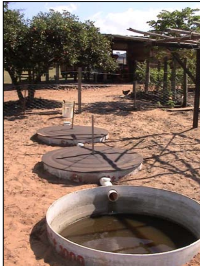
FIGURA 4.2 – Sistema da fossa séptica biodigestora instalado na Fazenda Morro Verde – Itirapina/SP
