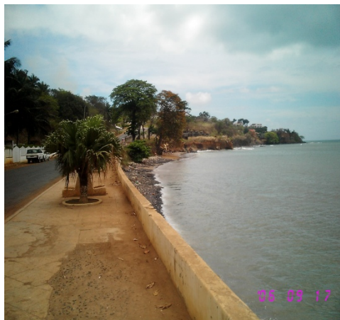
Foto 14 –Bairro do Hospital, área costeira destruída Fonte: SANTANA, 2010b:8/9.
