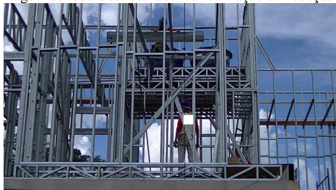
Figura 24 - Montagem de toda a estrutura sem a realização da vedação horizontal - laje
