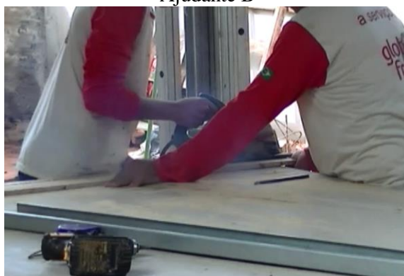
Figura 44 - Risco de acidente - Plaqueamento externo com placa de OSB - requadros - Montador B e Ajudante B
