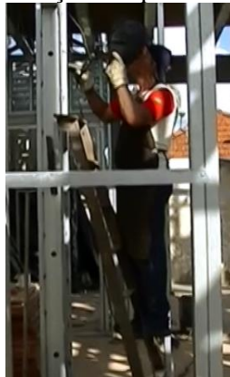
Figura 32 - Risco de acidente - Fixação dos painéis térreo - soldagem - Encarregado
