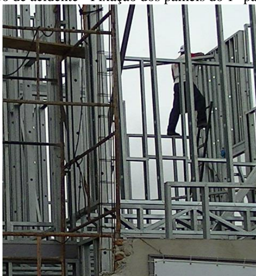
Figura 36 - Risco de acidente - Fixação dos painéis do 1º pav. - Encarregado
