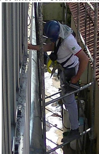
Figura 41 - Risco de acidente - Contraventamento - Montador C
