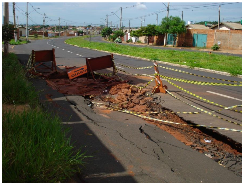
Figura 41 – Pavimento danificado no Parque Residencial Nova Esperança em São José do Rio Preto
