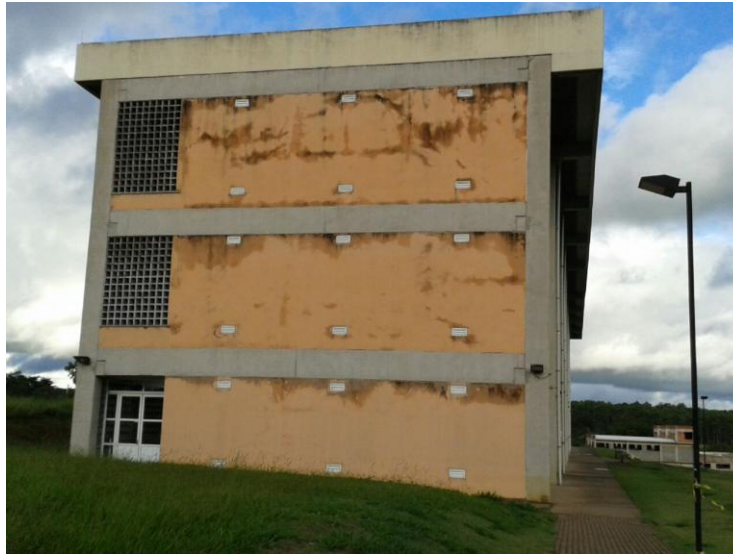
Figura 56 – Edifício AT7: infiltrações e fissuras
