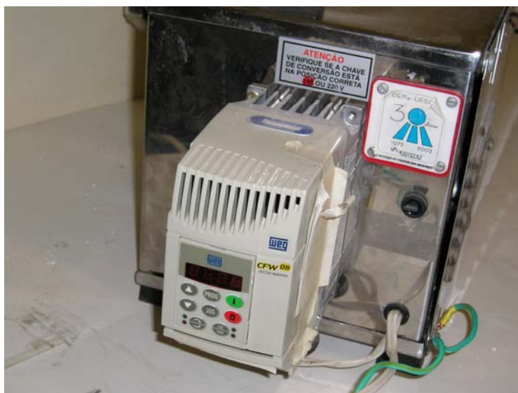
Figura 3.5 Dispositivo redutor de corrente, responsável pelo controle da velocidade do moinho de facas e do dispositivo de laminação.
