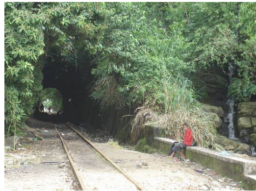
Figura 78 - Túnel José Menino em estado de abandono - 2007 Fonte: Novo Milênio (2014)
