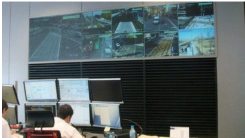
Figura 28 - Sala do CCO vista parcial Fonte: CCR (2013)
