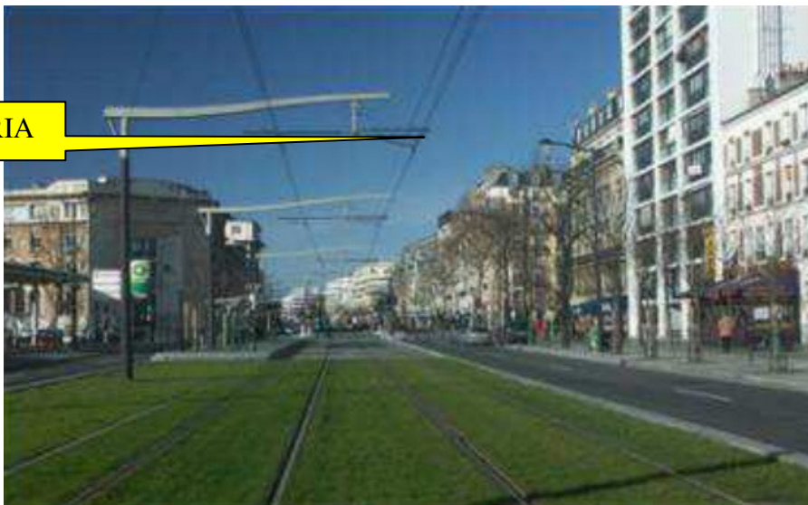
Figura 22 - Rede aérea de alimentação de um sistema de VLT - Catenária Fonte: CCR (2013)
