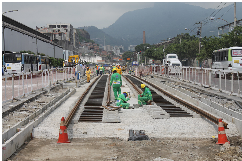
Figura 103 - Implantação dos primeiros 400 metros de trilhos do VLT do Rio Fonte: CDURP (2015a)
