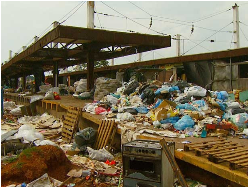
Figura 61 - Antiga estação do VLT invadida e ocupada por posseiros Fonte: Portal G1 (2012)
