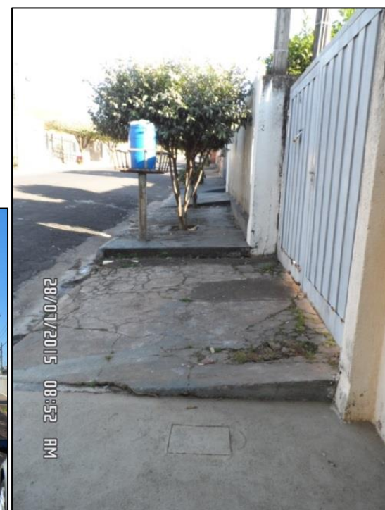
Figura 6. Degraus na calçada.
