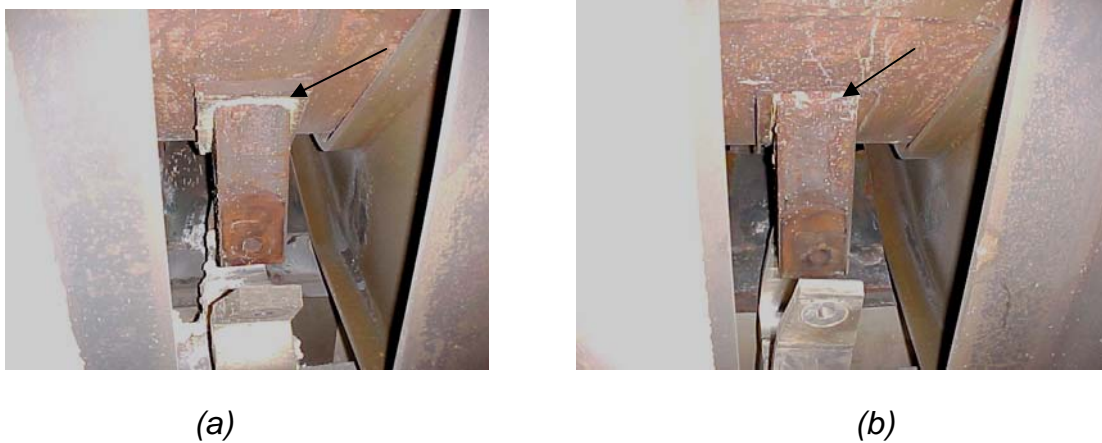
Figura 4.10 Região exposta da barra coletora a entrada de ar para o interior do revestimento de cubas (a) condição ideal, (b) falta de material refratário de preenchimento.
