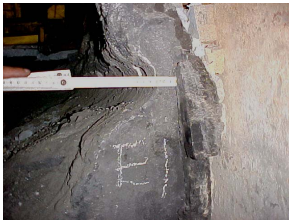
Figura 4.11 Degradação severa do bloco de carbono na cabeceira da cuba (dos 127mm originais de espessura, restaram apenas 30mm)
