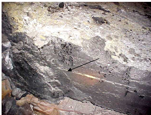
Figura 4.5 Trinca angulada no interior do bloco catódico.
