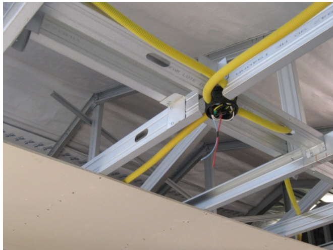
Figura 26: Tubulação passando por perfis da laje de cobertura
