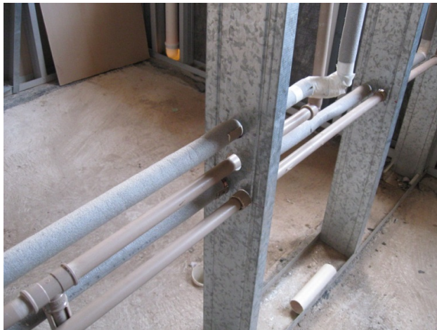
Figura 24: Tubulação passando por perfis de painel
