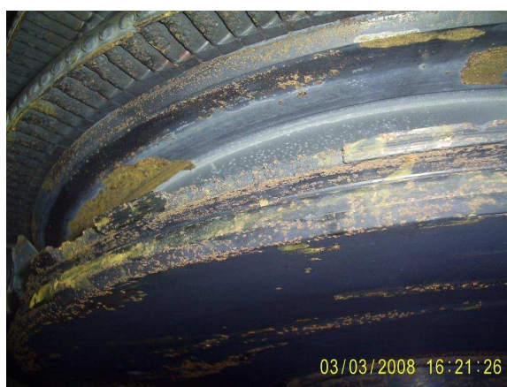
Figura 1.15 Detalhe de palhetas e disco com desgaste e corrosão.
