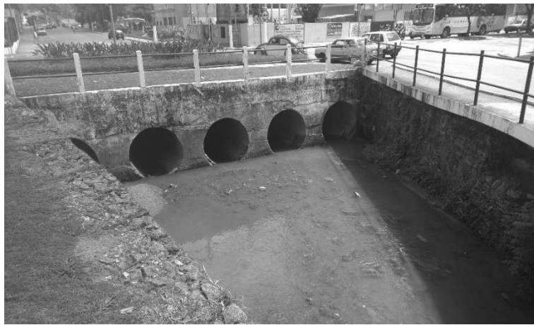
Foto 5 - Retificação, dimensionamento inadequado de tubulações e alto grau de impermeabilização em setor da baixa bacia
