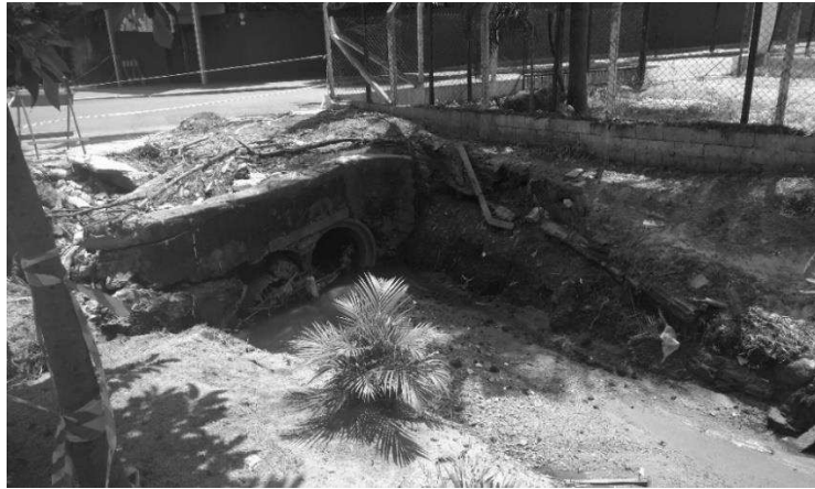
Foto 3- Abatimento de calçada sobre tubulação entupida do córrego da Figueira, um afluente da margem esquerda do Ribeirão Itapetinga
