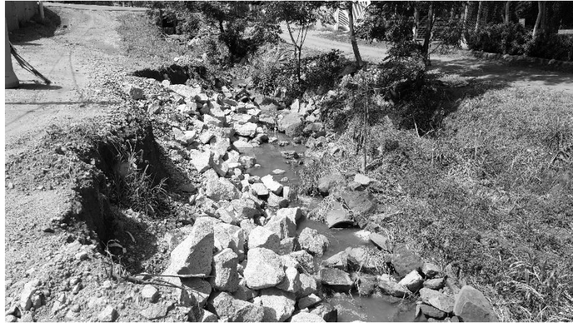
Foto 8 – Córrego preenchido por blocos, a jusante de represamento
