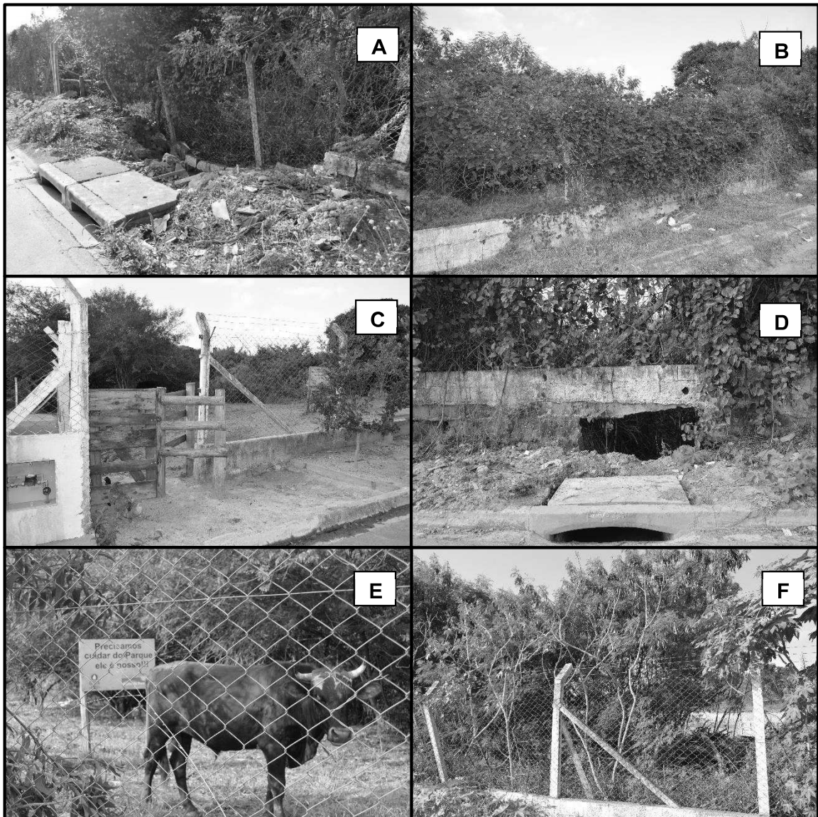
Figura 1.2. – Impactos que ocorrem no Parque Natural Municipal Olésio dos Santos. A) Entulho acumulado entorno do parque; B) Plantas crescendo por cima do muro; C) Presença de quebra-corpo; D) Buraco no muro, próximo a boca de lobo; E) Presença de animais domésticos no interior, e F) Presença de plantas exóticas ( Leucaena sp ).
