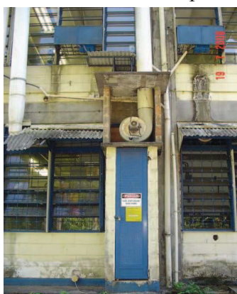
Figura 11: Bombas de Vácuo do Lab. de Produtos Naturais – UFSCar, Dep. Química.
