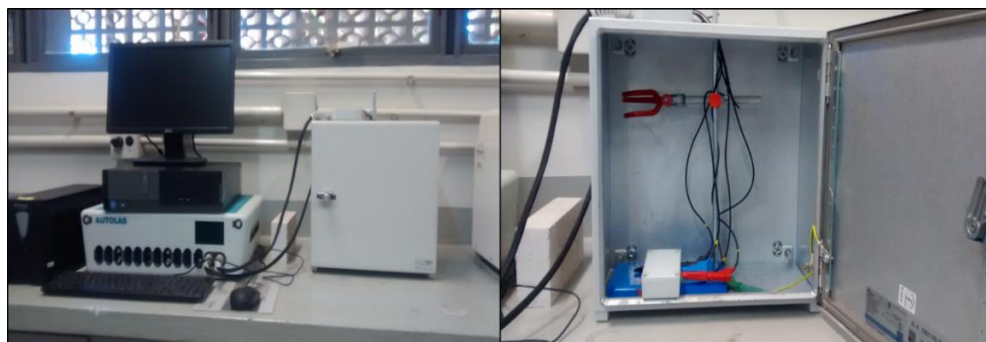
Figura 3.4.10.3 Sistema potenciostato-galvanostato instalado no CCDM/DEMa/UFSCar.
