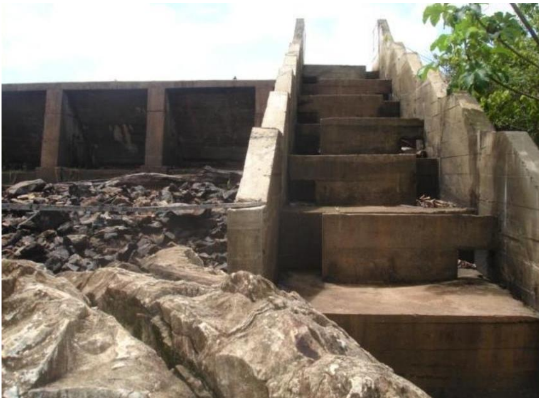
Figura 12: ESCADA SECA CONSTRUÍDA PARA REPRODUÇÃO DE PEIXES
