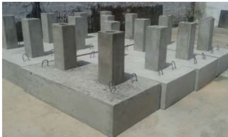
Figura 4.6 - Plataforma de sustentação de tubulação
