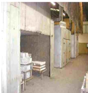
Figura 3.4: Estufas industriais utilizadas na secagem dos produtos refratários, com temperatura máxima de 125°C.
