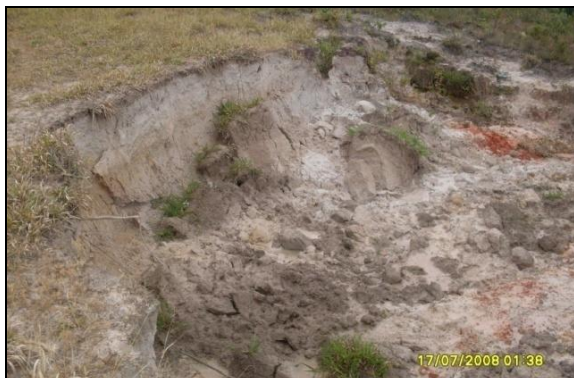
Figura 25: Erosão na Comunidade do Cedro Autor: Jesiel Silva
