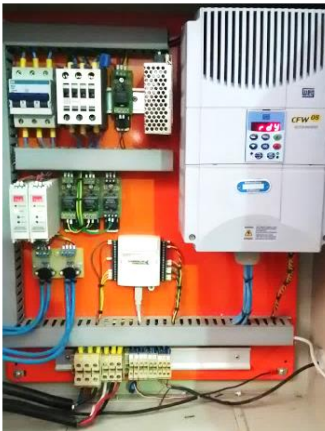
Figura 35 – Painel de controle do equipamento de filtração
