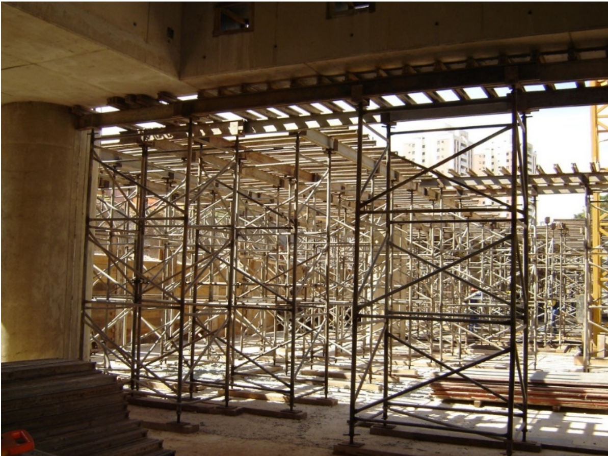
Figura 2-24 - Quantidade elevada de escoramento provisório no sistema construtivo moldado no local
