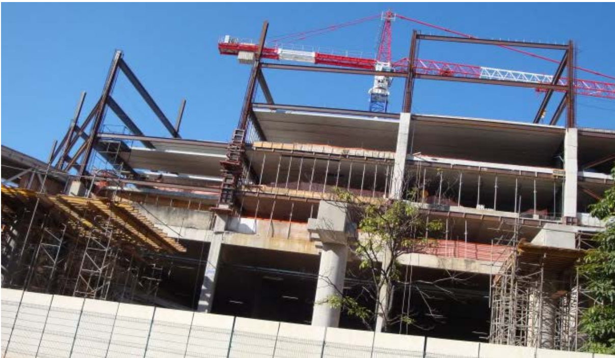
Figura 2-3 - Estrutura mista com perfis de aço (pilares e vigas) para depois serem concretados
