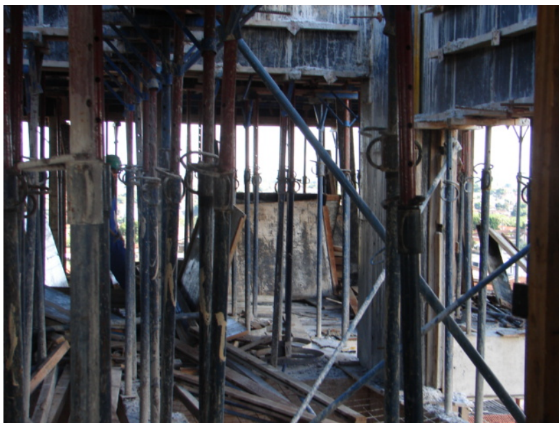
Figura 3-13 - Alta quantidade de escoramentos impossibilitando trabalhos no pavimento
