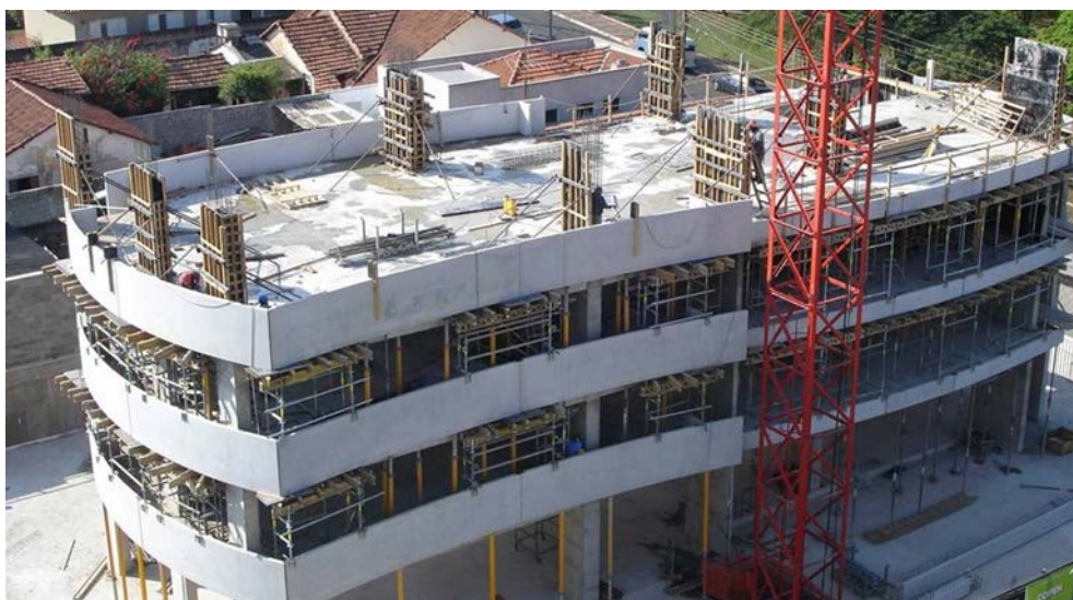
Figura 1-1 - Edifício em construção com sistema construtivo híbrido, com vigas e lajes pré-fabricadas e pilares moldados no local
