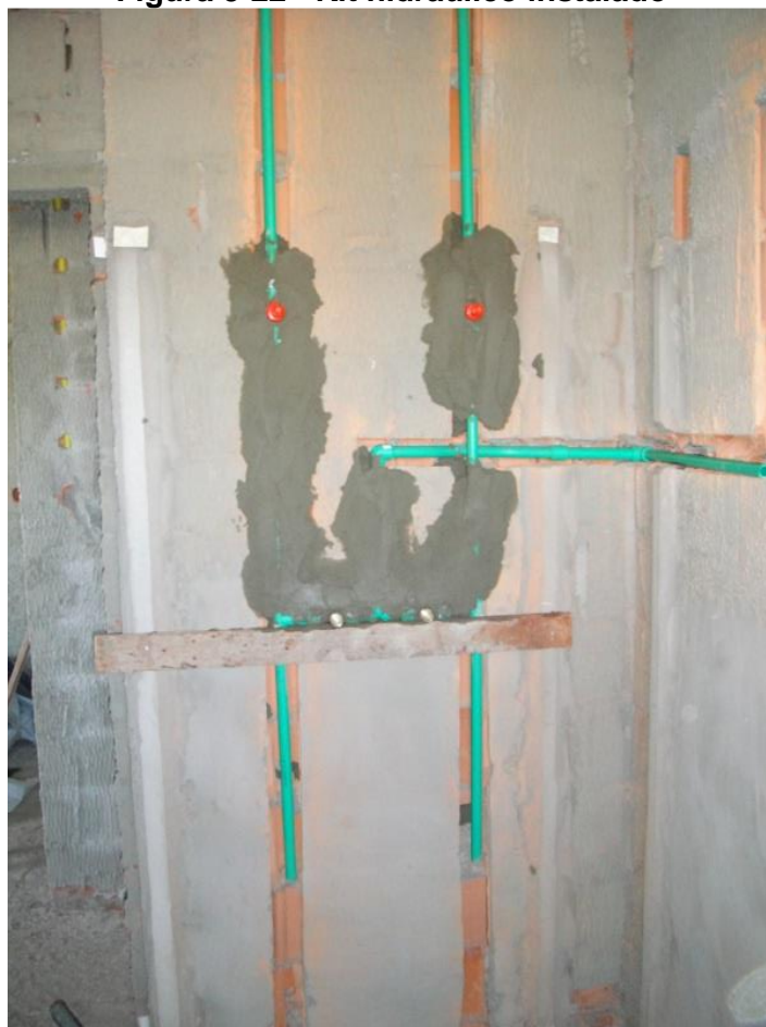
Figura 5-22 - Kit hidráulico instalado
