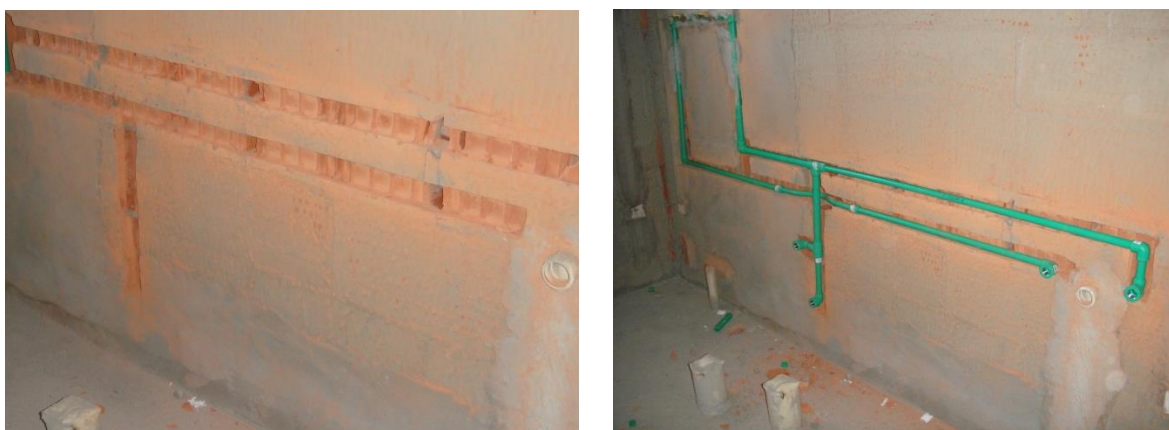
Figura 5-15 – (a) Alvenaria aberta esperando instalação hidráulica; (b) Ramais e sub-ramais de PPR na alvenaria.
