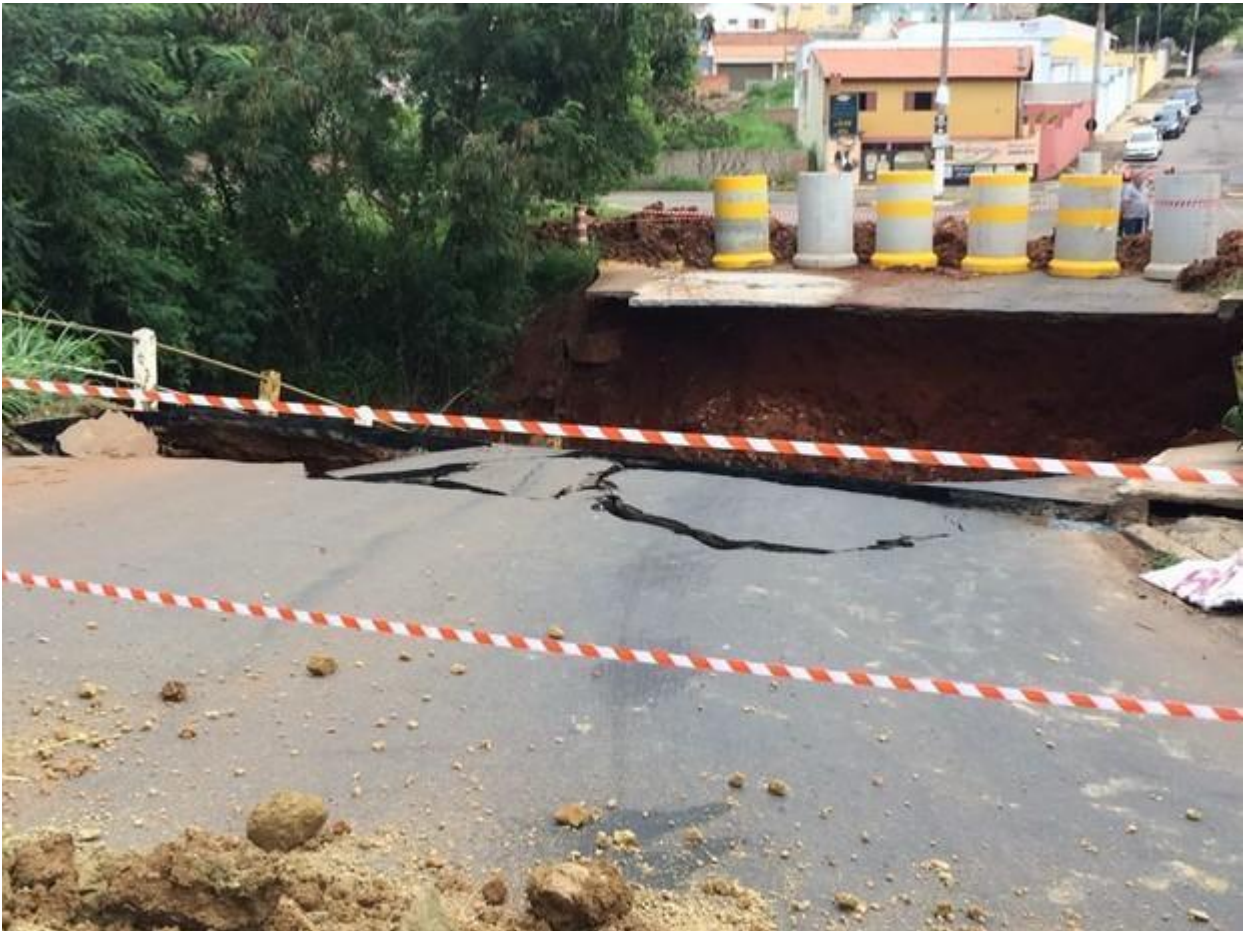
Figura 36. Ponte derrubada pela sobrecarga do Rio Tatuí causada pela impermeabilização do solo e pela alta pluviosidade da época (2017).
