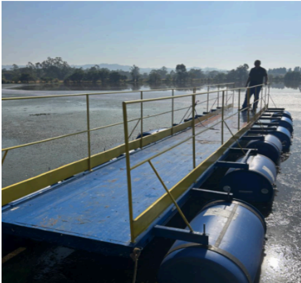
Figura 5 – Foto da plataforma flutuante instalada na lagoa facultativa
