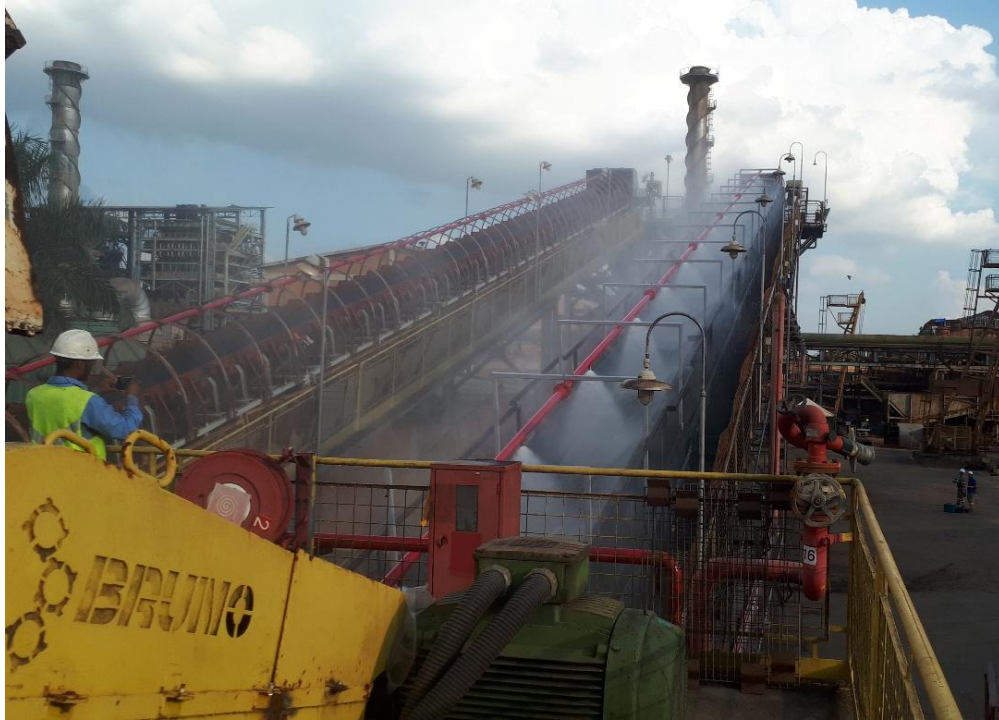
Figura 19 - Sistema de tubulações com sprinklers em esteiras transportadoras
