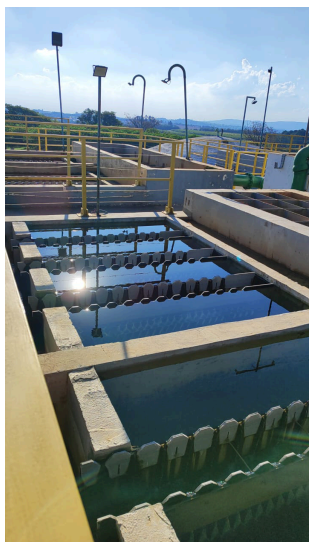
Figura 4 – Estação de tratamento
