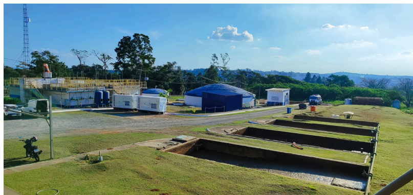
Figura 5 – Estação de tratamento
