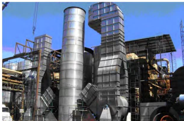
Figura 3. 3 - Lavador de gases em aço 410D [7].
