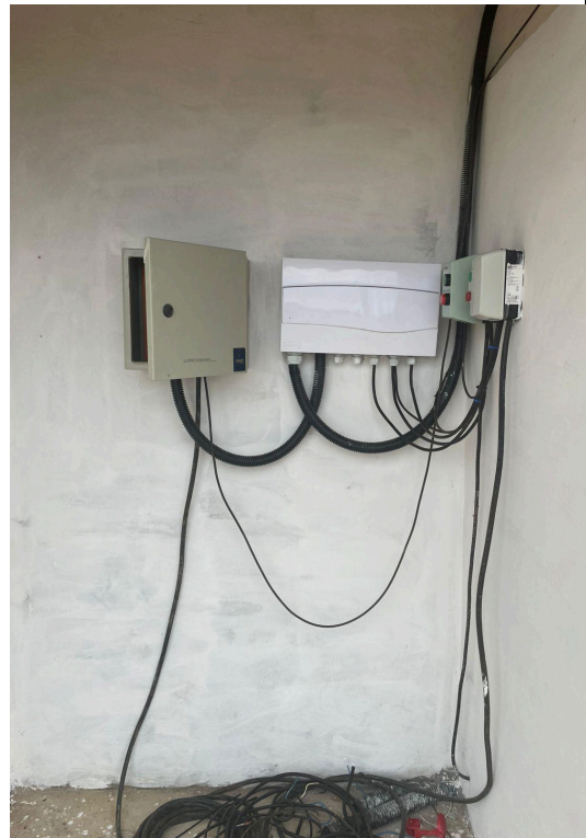
Figura 6: Disjuntor de comando
