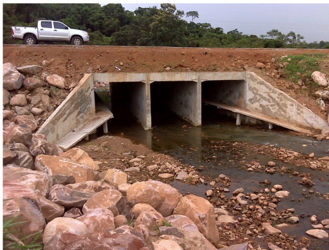
Figura 9. Passagem de fauna subterrânea e drenagem, na BR-158, no município de Confresa (MT). (Foto: DNIT - Departamento Nacional de Infraestrutura de Transportes, 2014).
