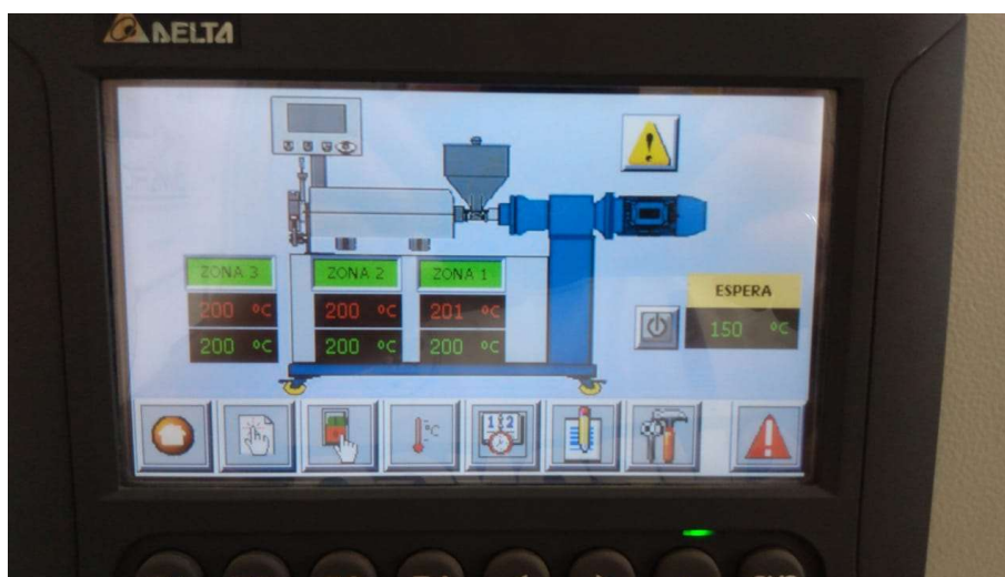
Figura 7 - Painel de comando acoplado a extrusora.
