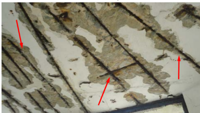
Figura 3 - Corrosão em armadura da laje de cobertura de reservatório
