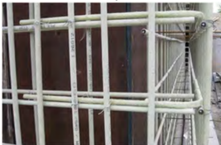
Figura 8 - Detalhe da armadura de canto das paredes do reservatório de Quebec, Canadá.
