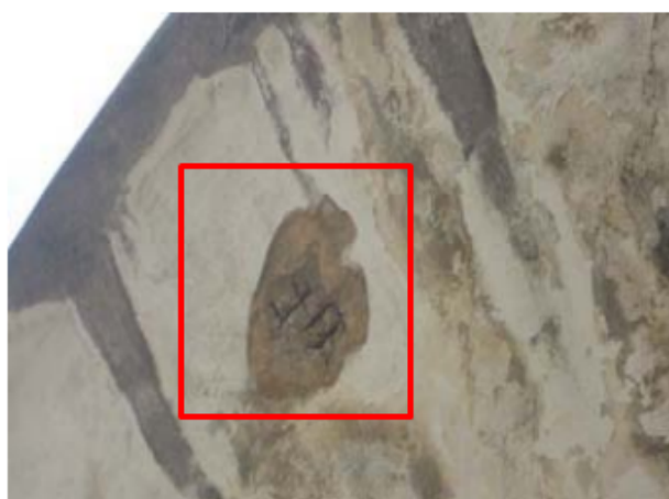
Figura 2 - Corrosão em armadura da laje de fundo do reservatório
