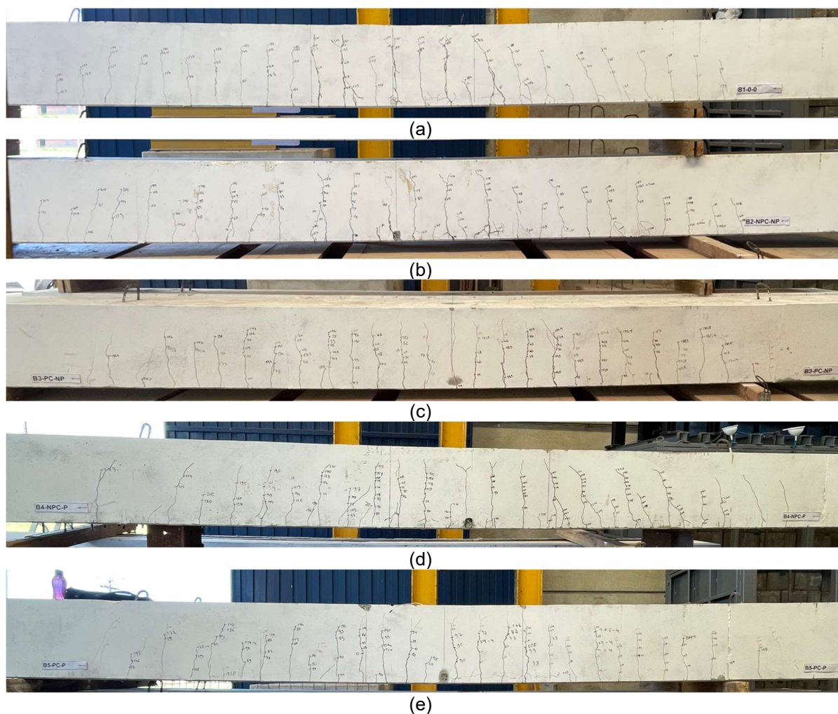
Figura 129 – Padrão fissuratório final das vigas ensaiadas
