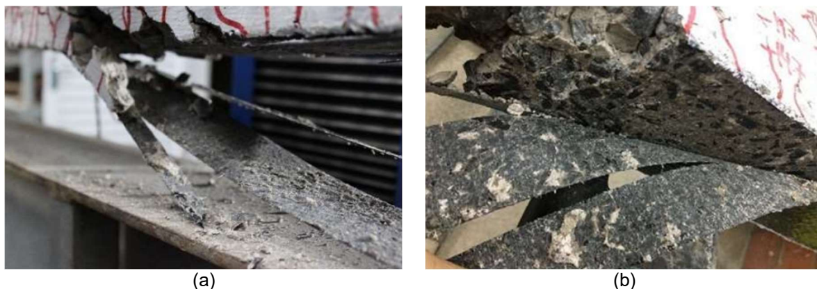
Figura 2 – Ruptura por descolamento do FRP em viga de concreto armado submetida à ensaio de flexão
