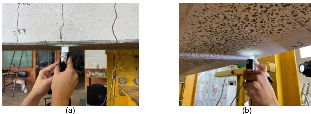
Figura 95 – Aferição da abertura de fissuras com microscópio digital
