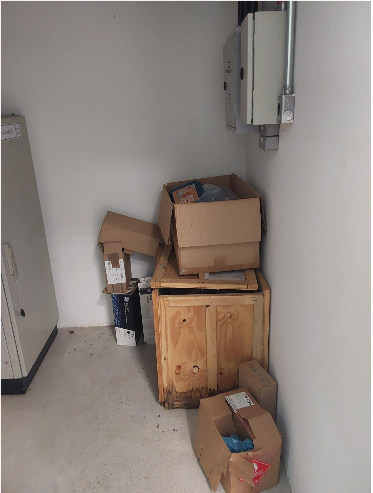
Figura 16: Sala de quadro de energia com descarte
